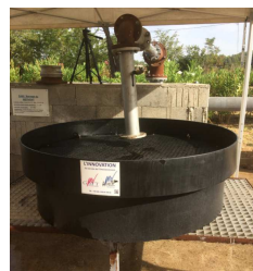
Filtro instalado con DN100
