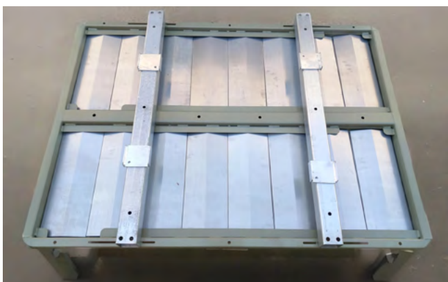
Retención total del aceite dieléctrico
